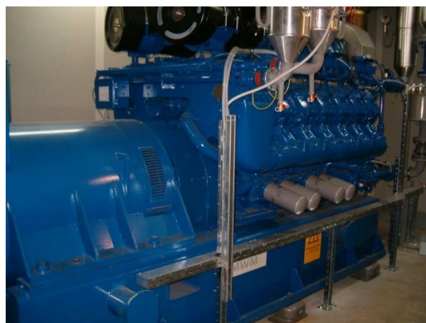
Slika 7: Kogeneracija na toplarni na Štibuhiu.
